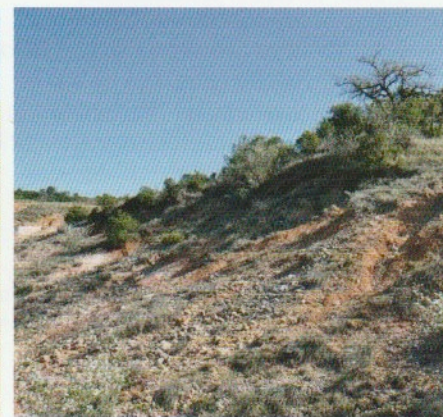
Photo 7. - Base érodée, face Nord
